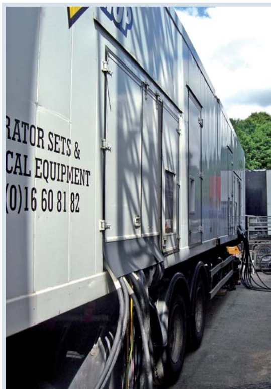
Trappe sur un groupe électrogène permettant de laisser passer les câbles sans donner accès aux connecteurs.
